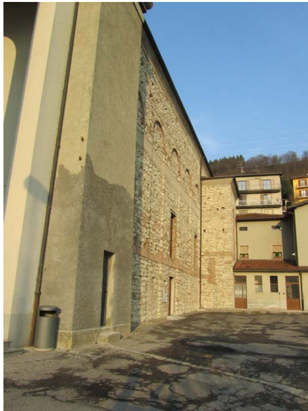
Le volume de l'église est véritablement disproportionné par rapport à la modestie du village. Sa structure architecturale montre à l'évidence qu'un nouveau et monumental portail a été construit postérieurement devant un bâtiment plus ancien.
